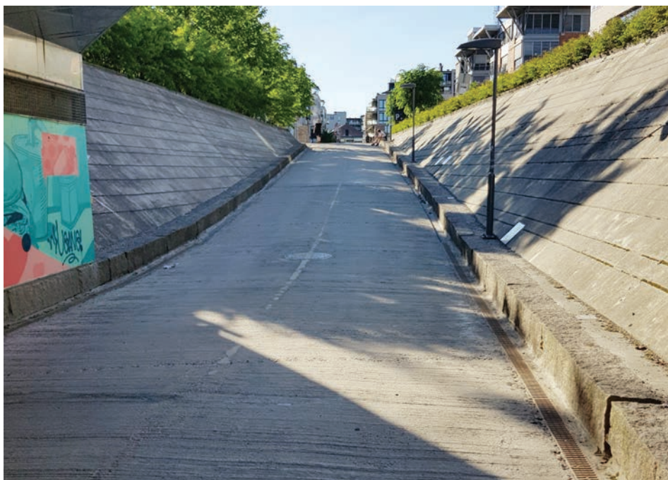
Gang- og sykkelvei i Drammen som er for lang og bratt, og som mangler hvilerepos. Foto: Tove H. Skyer.
